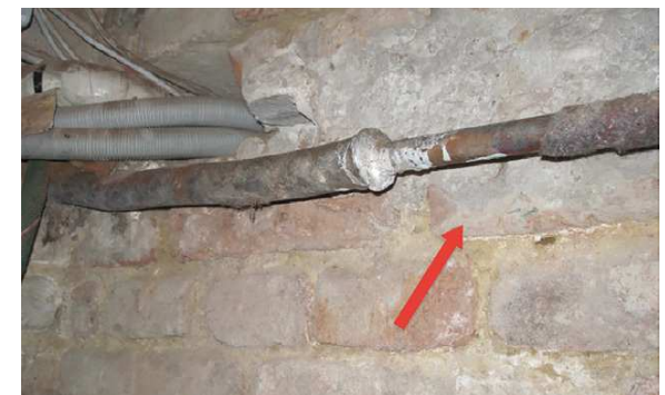
Abbildung 2: Beispiel einer Mischinstallation aus Gebäude PE42: Kupferhäftiges Material (roter Pfeil) wurde nach Blei verbaut.
